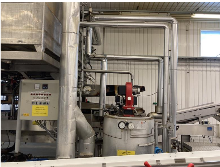
Tehtaan sisäpuolella oleva käyttölaiteisto
