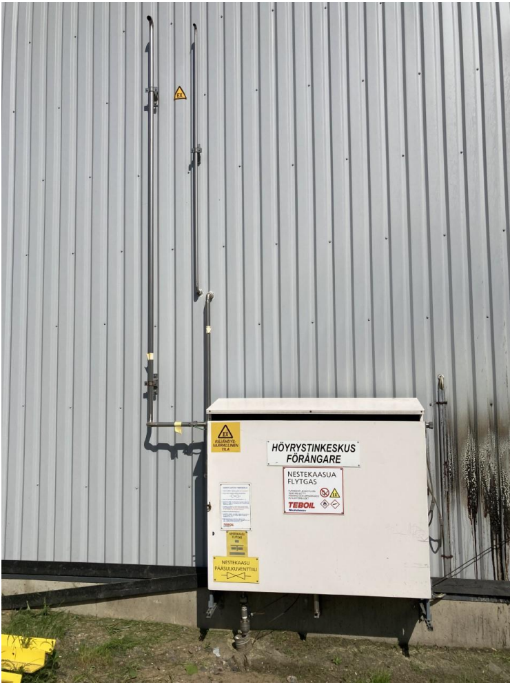
Ulkoseinällä oleva höyrystinkeskus
