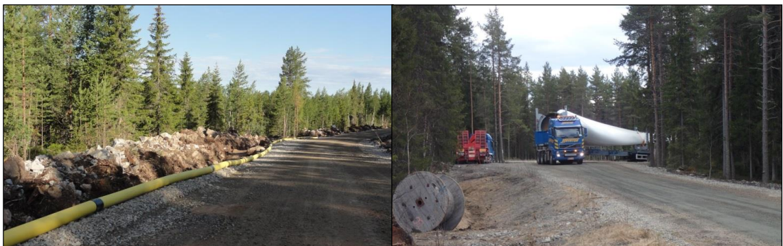
Kuvapari 2-15 (Vasemmalla) Esimerkki tuulivoimapuiston rakennus- ja huoltotiestä rakentamisaikana. Teitä käytetään muun muassa betonin, soran ja voimaloiden komponenttien kuljetuksiin sekä tuulivoimapuiston käyttövaiheessa huoltoajoihin. Maakaapeli sijoitetaan ojakaivanton tien reuna-alueelle. (Oikealla) Tuulivoimalan osia kuljetetaan erikoiskuljetuksina. (Kuvat: Ville Suorsa, FCG).
