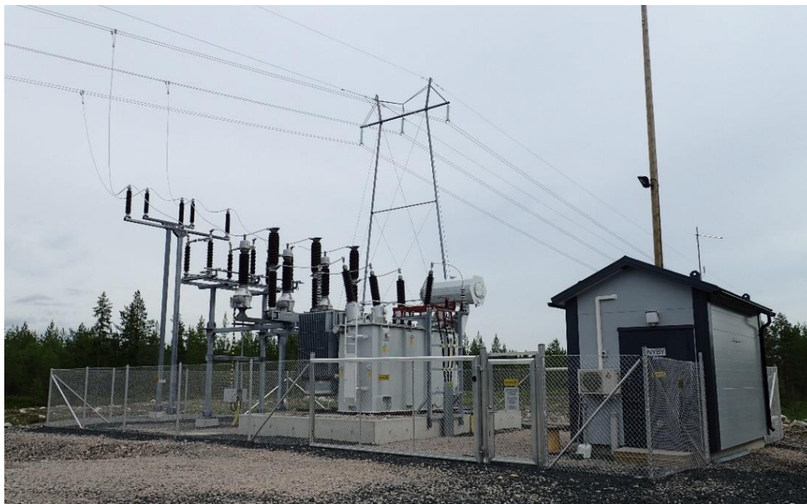
Kuva 2-16 Esimerkki tuulivoimapuiston sähköasemasta.
